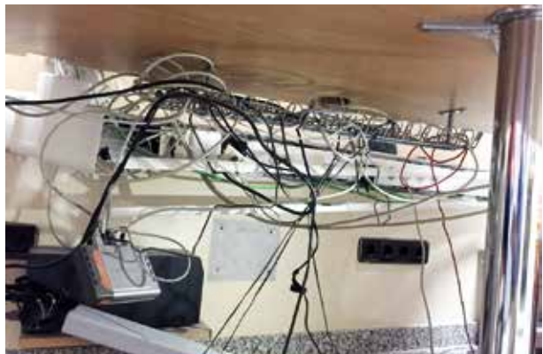
Chaos unter dem Schreibtisch – die Kriminellen haben Alarmanlage und Elektroinstallation in der Praxis fachmännisch demontiert.
